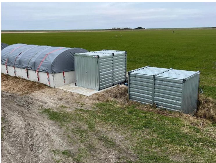
Figuur 4. Installatie Hoofdweg met meet- en regelunit, papierbandfilter en boogkappen
